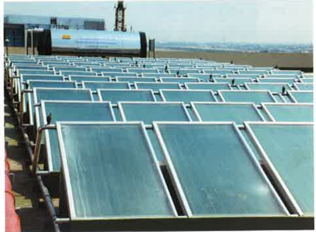
รูปที่ 5.7 แผงรับรังสีดวงอาทิตย์และถังเก็บน้ำร้อน ระบบผลิตน้ำร้อนพลังงานแสงอาทิตย์ โรงพยาบาลศูนย์วิจัยศึกษาโรคมะเร็ง สถาบันวิจัยจุฬาภรณ์
