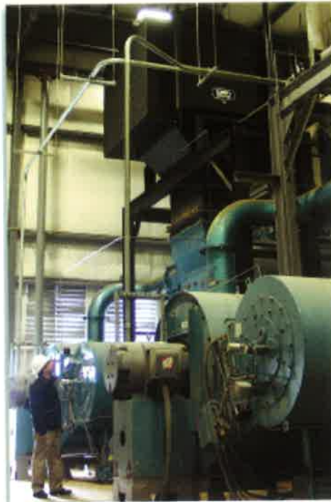
รูปที่ 3.7 การเชื่อมต่ออุปกรณ์ทำน้ำร้อนที่ปล่อยไอเสียของหม้อไอน้ำ
