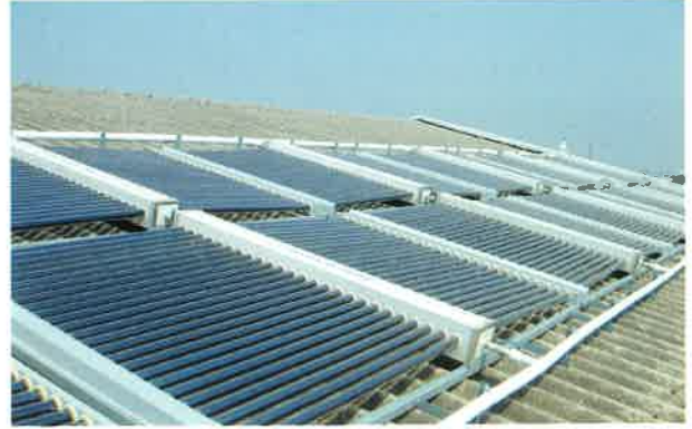
รูปที่ 5.10 ระบบผลิตน้ำร้อนพลังงานแสงอาทิตย์ โรงพยาบาลพุทธชินราช จ.พิษณุโลก
